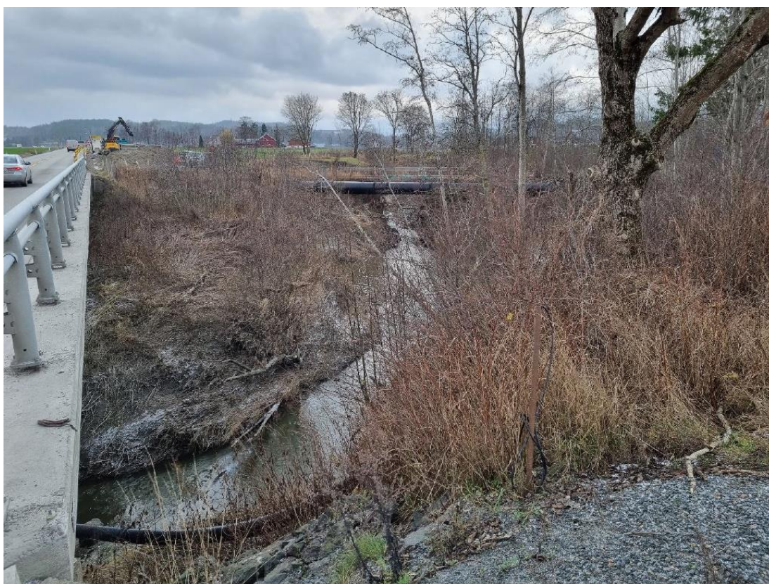
Figur 8. Høsten 2022 ble det boret ny vannledning under Vesleelva som hensyntas under dette prosjektet.
